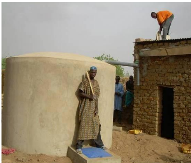
Photo 26: Impluvium en ferrociment
