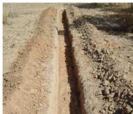
Photo 14 : la terre fertile de surface a été placée à droite, la latérite rouge à gauche
